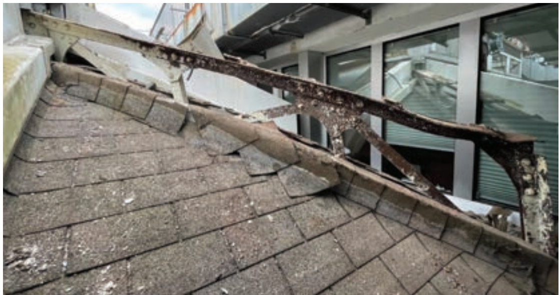
Deformaciones por golpes en ménsulas.
