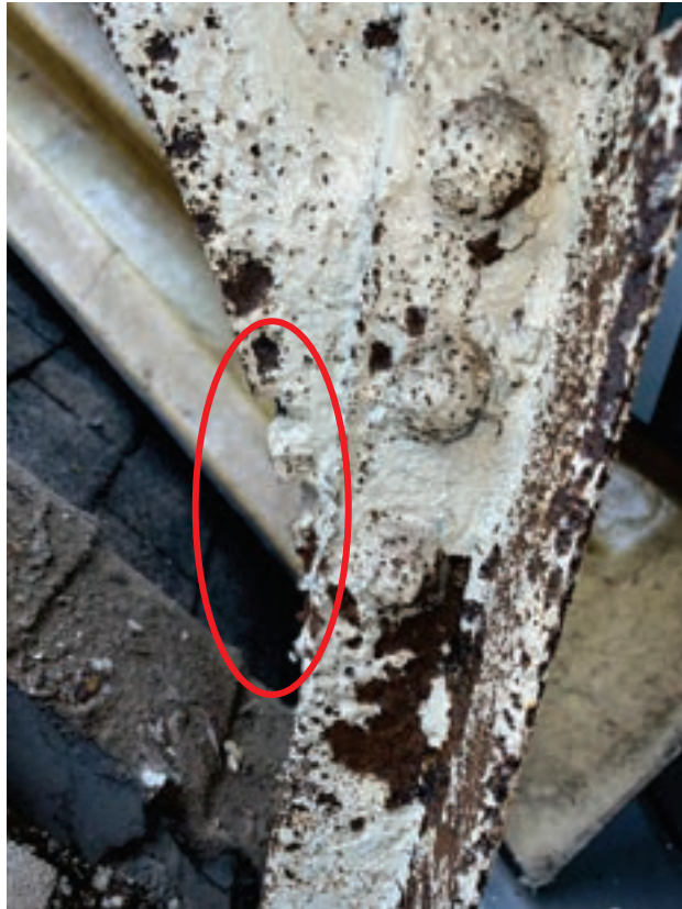
Pequeña rotura del borde de la cartela (antigua, ya pintada)
