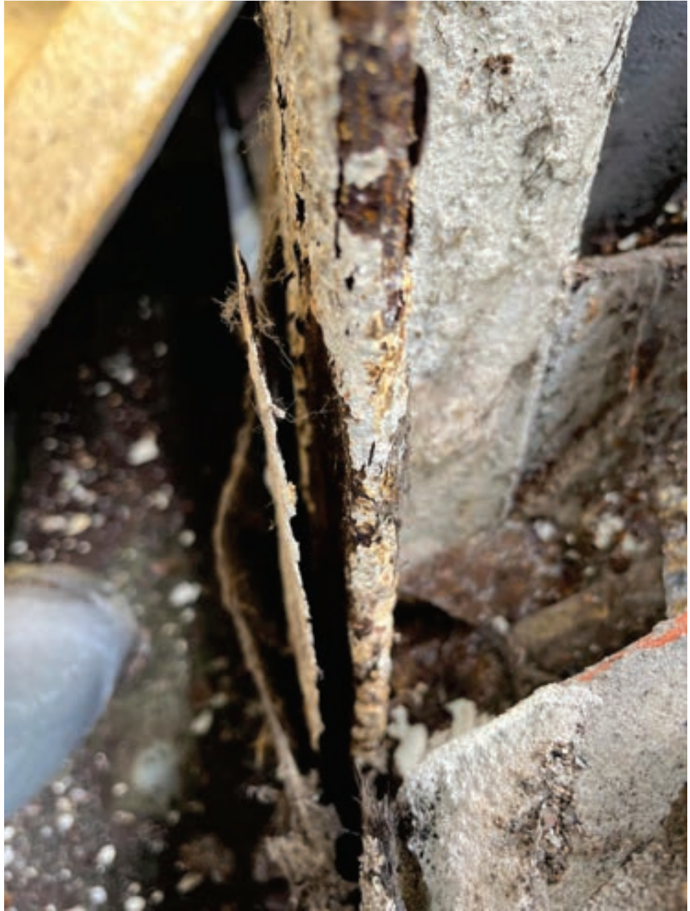
Exfoliación de acero por oxidación en encuentro con pesebrón
