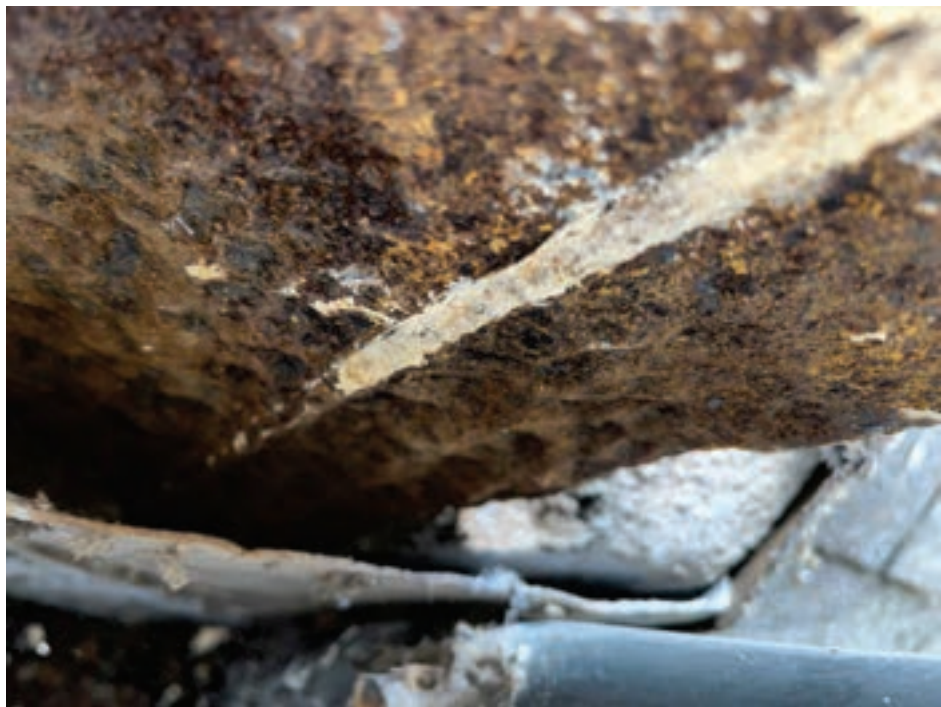
Oxidación con pérdida de sección grave en unión con pesebrón (>50%)
