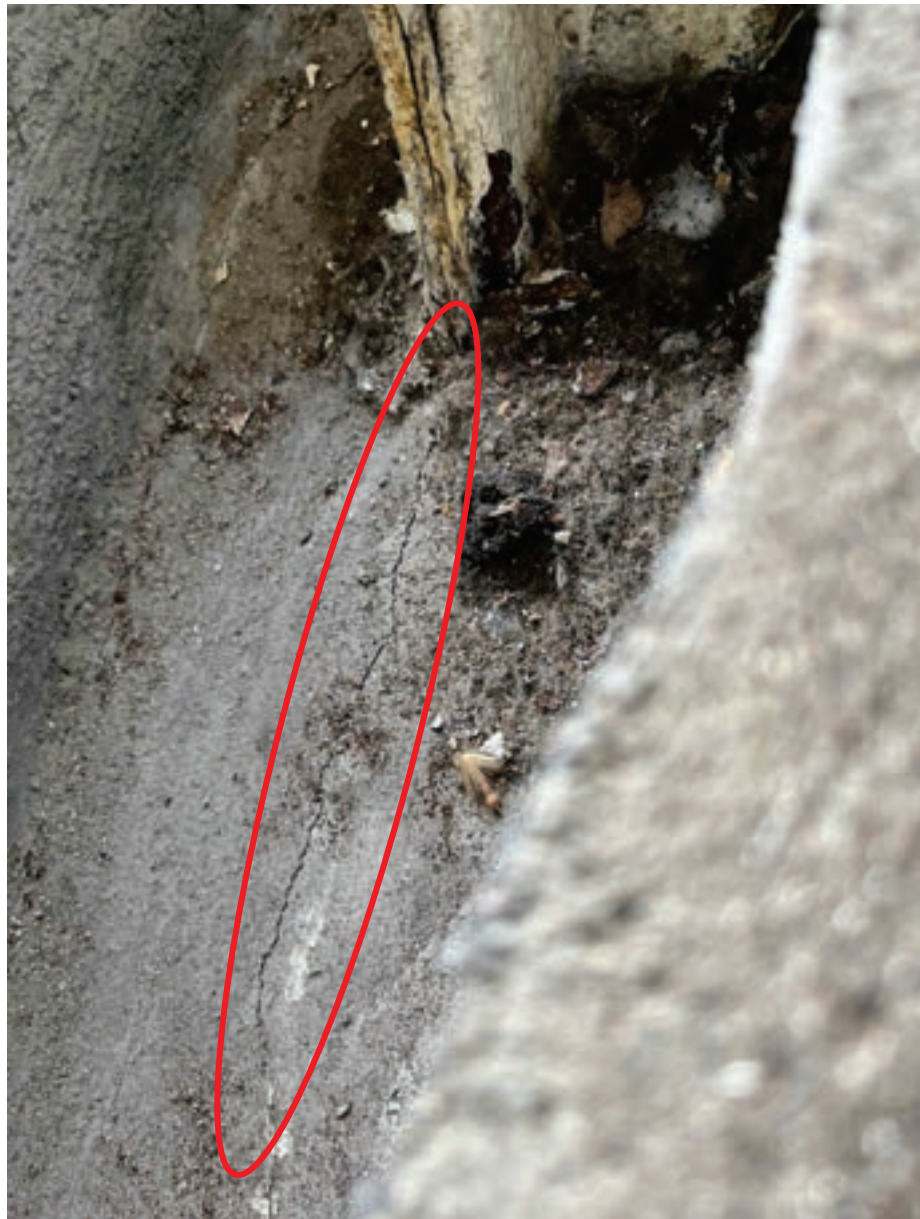
Fisura en mortero de bóveda
