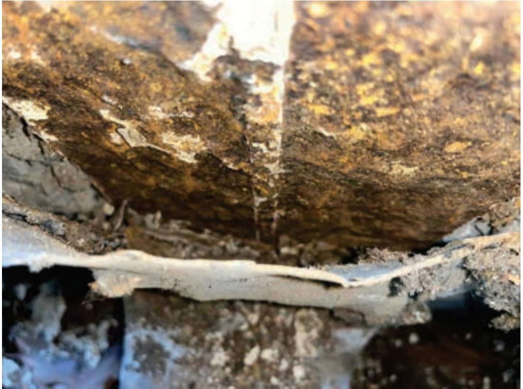
Oxidación con pérdida de sección en encuentro con pesebrón
