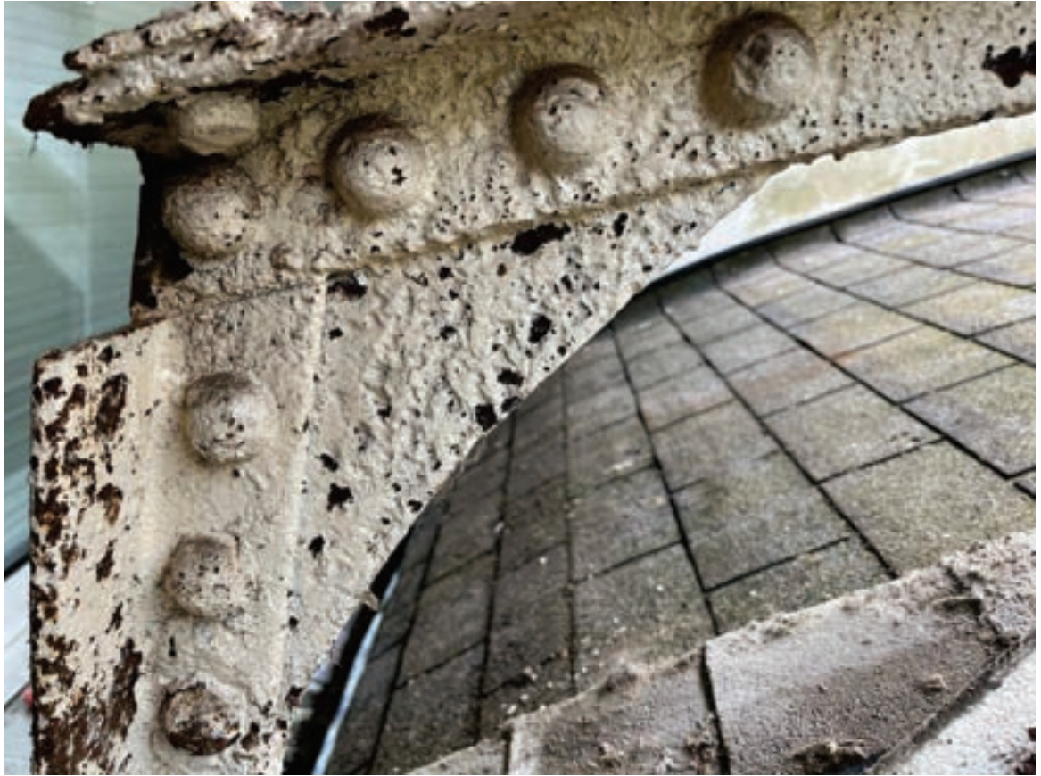
Oxidación por picaduras en cartela
