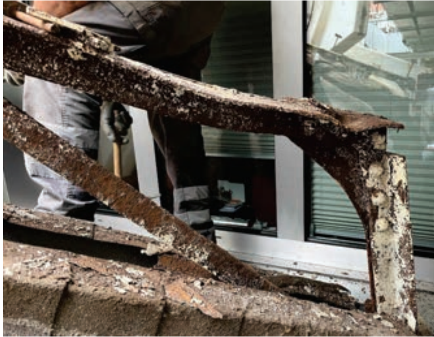
Zona con abolladura por golpe
