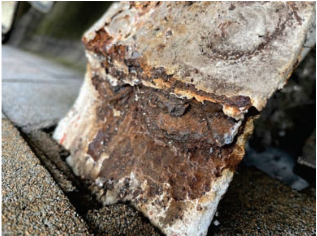
Oxidación con pérdida de sección en encuentro con lucernario
