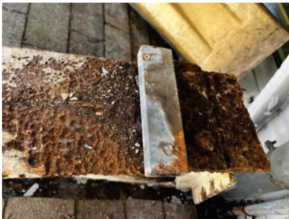
Zona con oxidación del cordón superior
