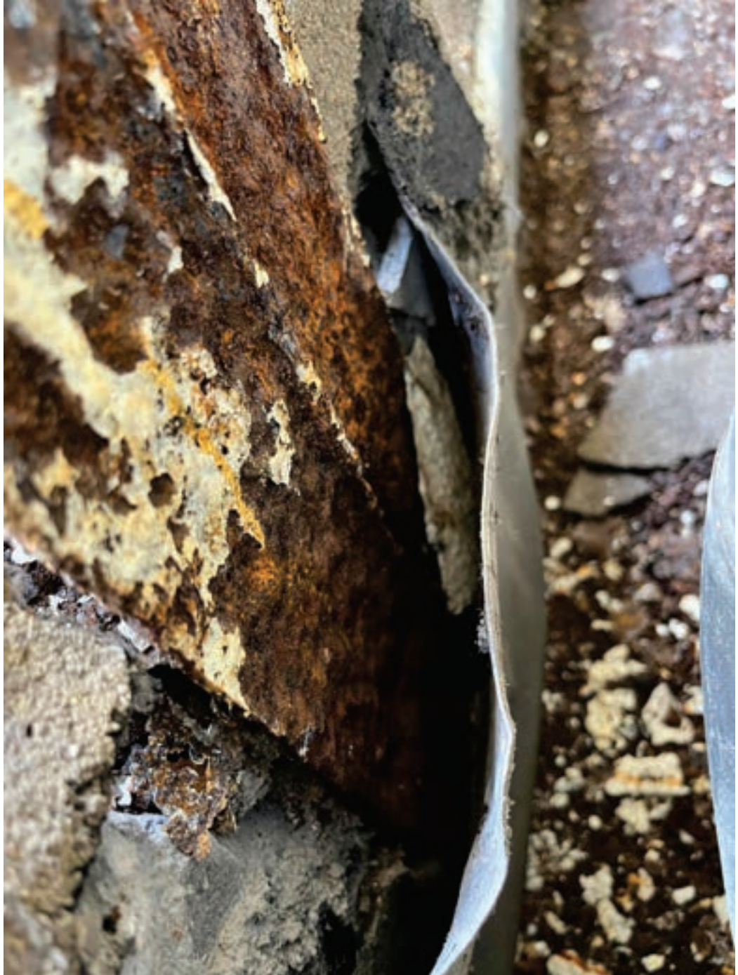
Oxidación grave de la base del montante
