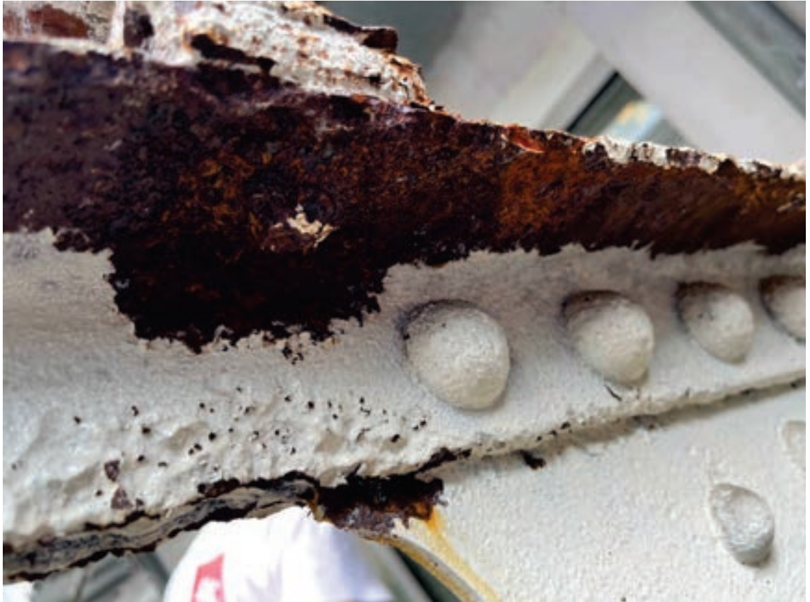
Oxidación en borde de cordón superior
