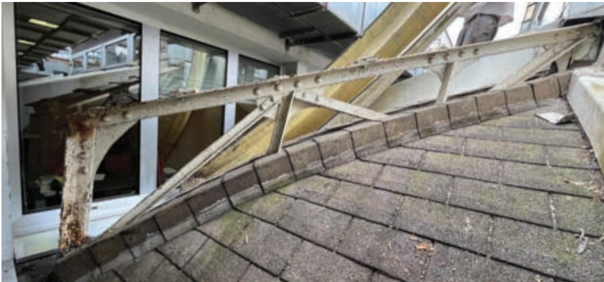
Ménsula de esquina sin cubierta de protección
