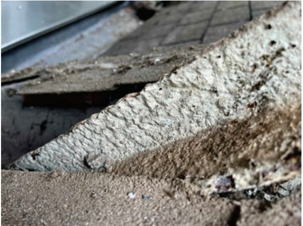
Picaduras en tirantes de cercha
